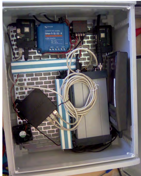
Figure 2.13 : Boîtier qui contrôle la réception
